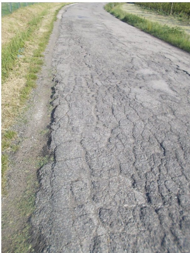
Via Banaffa – particolare di fessurazioni
