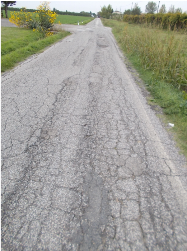
Via S.Orsola – particolare di avvallamento
