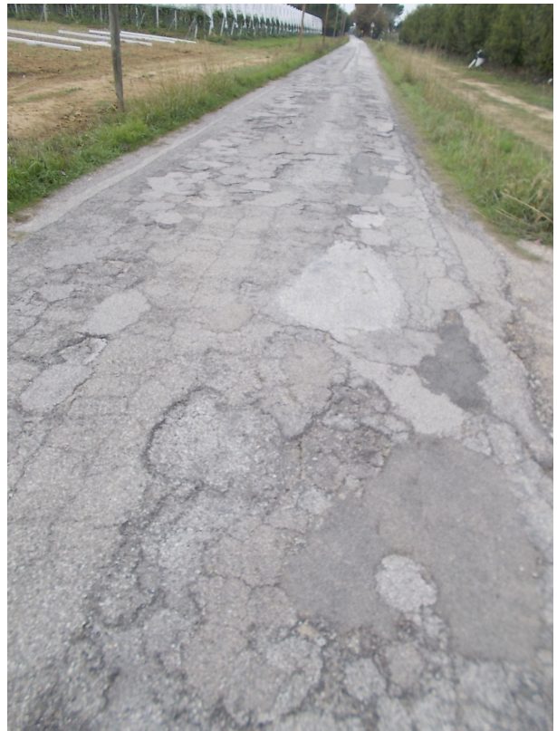
Via S.Orsola – deterioramento manto stradale
